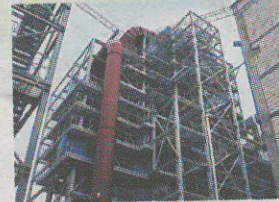
Kocioł wraz z konstrukcją stalową. Zakład Unieszkodliwiania Odpadów Komunalnych w Białymstoku
