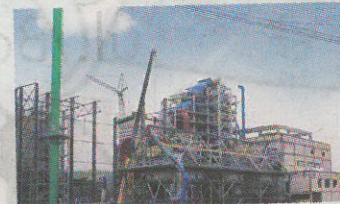
Widok ogólny. Zakład Unieszkodliwiania Odpadów Komunalnych w Białymstoku
